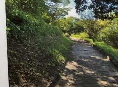
⑩園路 路面がガタガタになっており、通行しにくい状態となっている。
