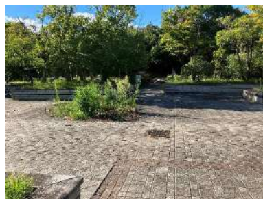
③植栽樹 随所に植栽樹がつくられており、草が繁茂している。
