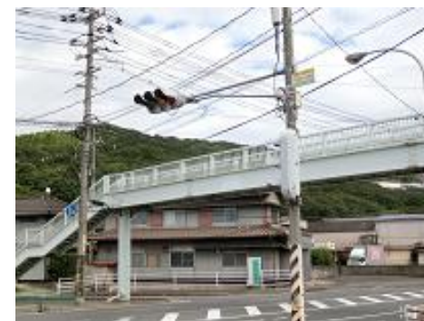
【防犯カメラ設置例】
