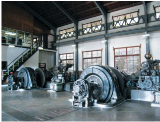
建物の1階にある発電機
