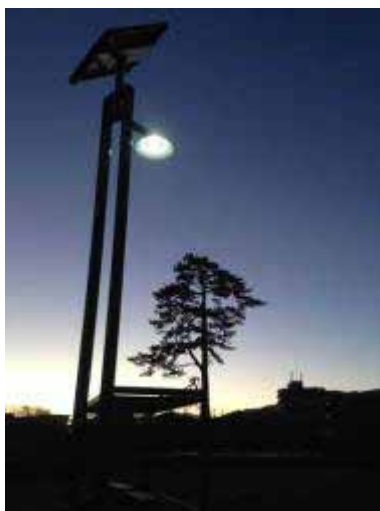
太陽光パネルをもつ公園照明の例 (省エネ照明の例)
