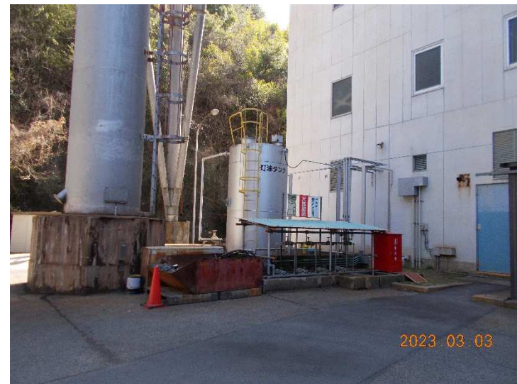
その他 灯油タンク
