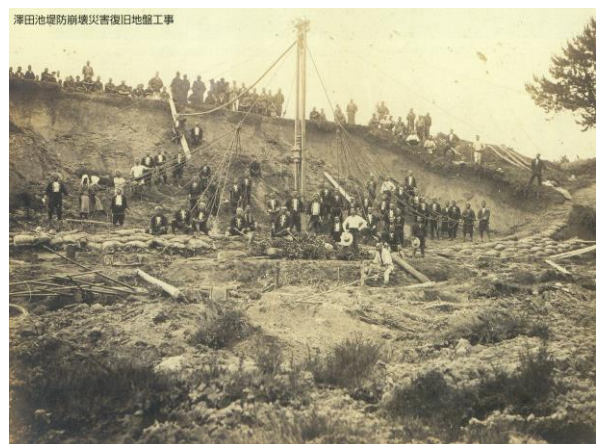
堤防決壊に伴う改修工事・沼隈郡津之郷村 消防団・青年団
