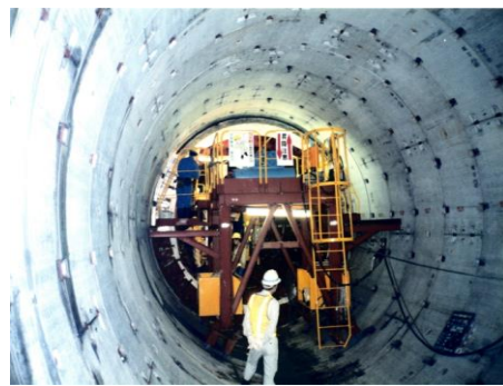
〔合流式下水道管〕
