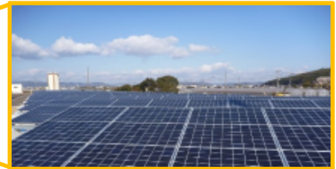
設置されている太陽光パネル
