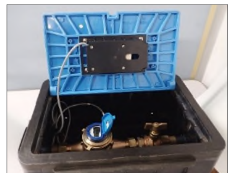
水道スマートメーター
