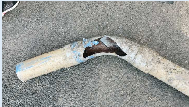
橋梁添架部の漏水(鋼管)
