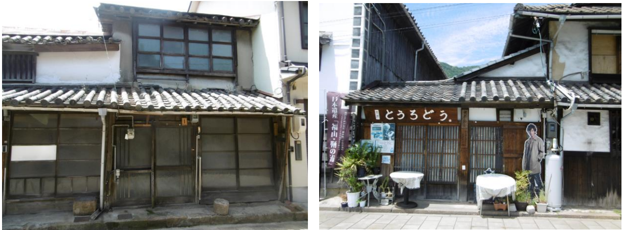
蟻羽がはみ出し、壁を共有している建築物
