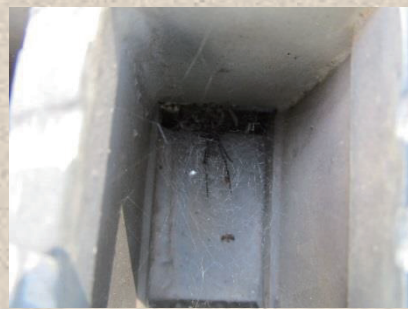
グレーチングに巣を築いた状態
