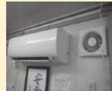
扇風機や換気扇とエアコンを併用
