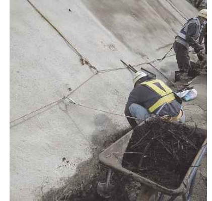
作業時なるべく離隔を確保
