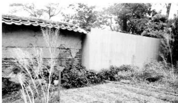
土塀破損状況
