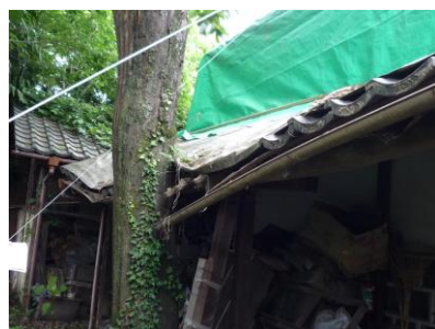
樹木と米蔵屋根の干涉
