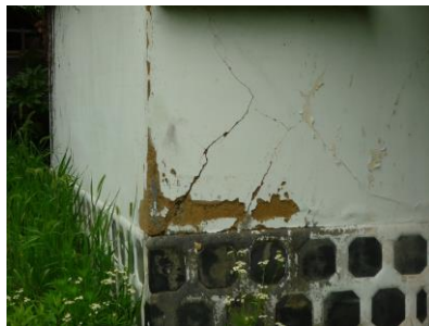
壁面のひび割れ, 崩落
