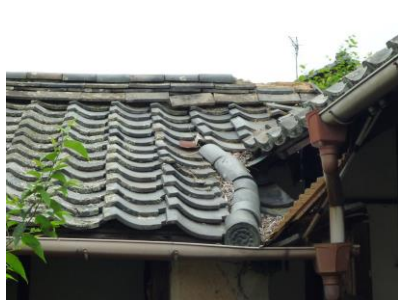
寮舎屋根の劣化（瓦崩落）
