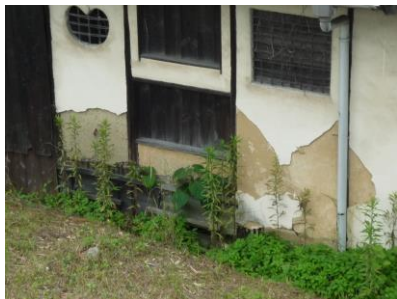
壁面（漆喰）の剥離
