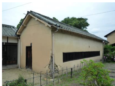
寮舎全景（壁面の崩落）
